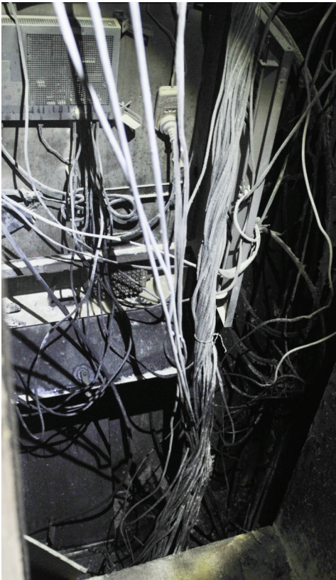
弱电井内的通信线缆被烧
