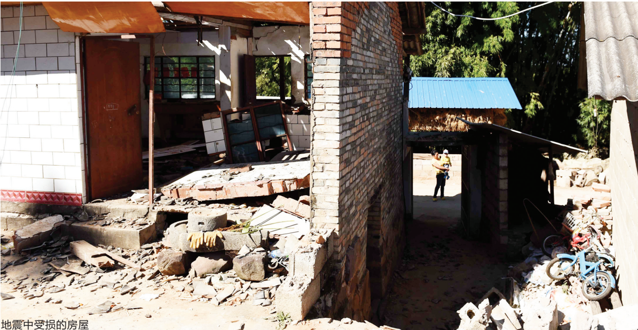
地震中受损的房屋
