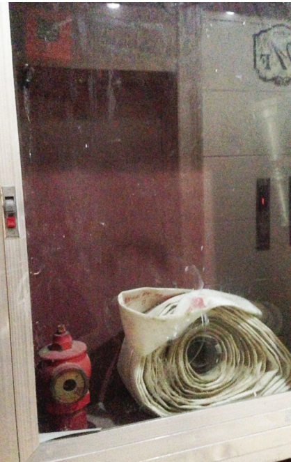
恒盛豪庭的一处消防栓是坏的
