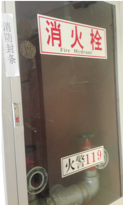
金荷苑小区里一处消防箱里空空的
