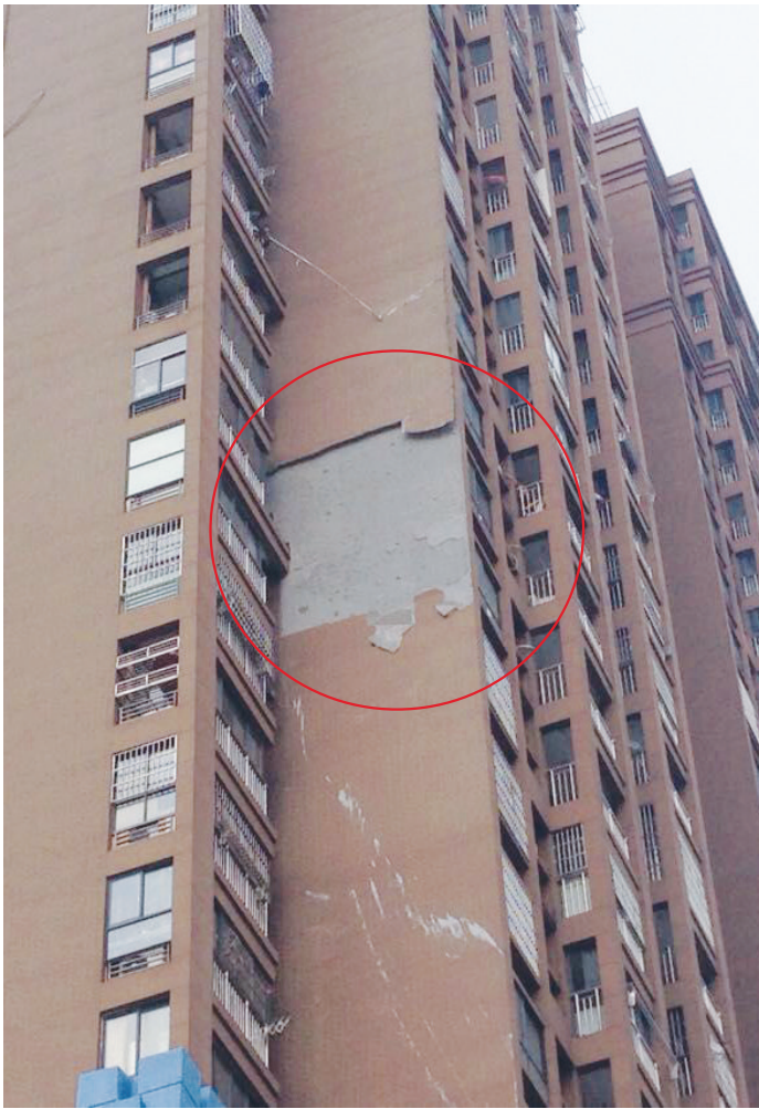
脱落大块保温层的外墙
