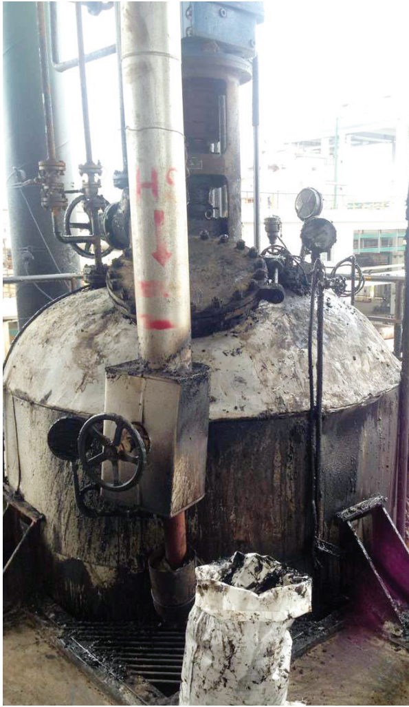
发生泄漏的生产装置
