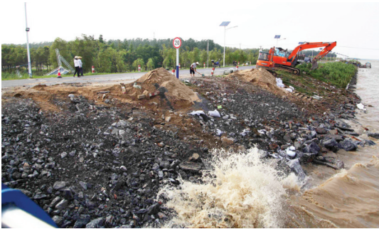
被巨浪拍塌的护坡
