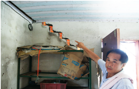
房屋有的开始不同程度地开裂、移位
