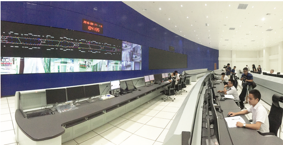
珠江路车辆段 地铁控制中心大厅
