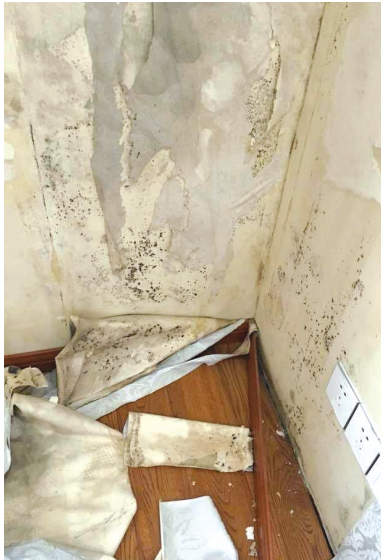
墙纸脱落,墙面成了“大花脸”
