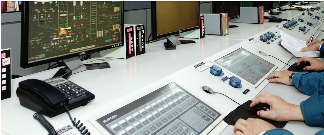
热电集团集控室
