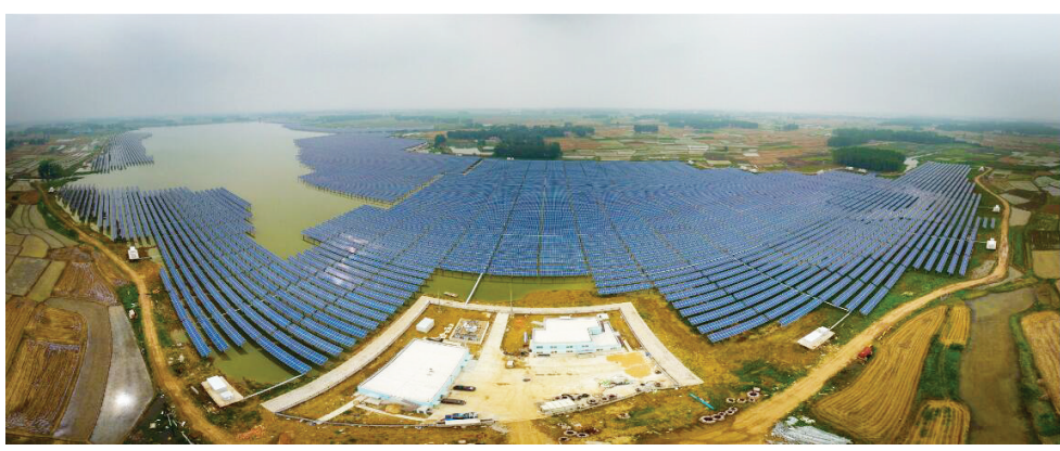
长丰朱巷渔光互补光伏发电
