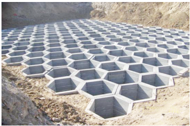
蜂巢结构蓄水池
