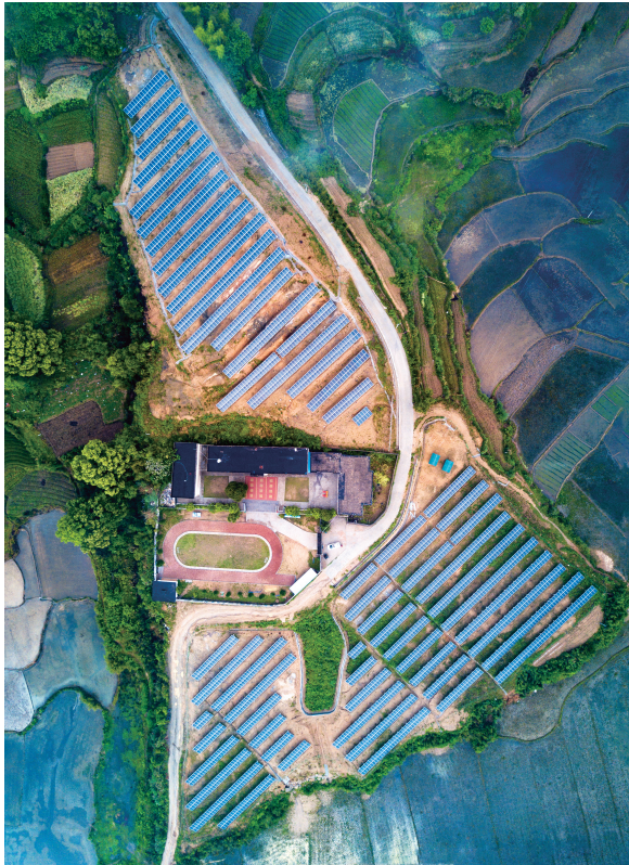
岳西光伏发电项目 储青/摄
