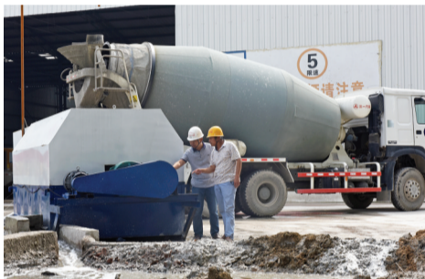
6月13日,中铁上海工程局商合杭高铁11标准南制梁场工人通过混凝土砂石分离机、污水处理系统,对搅拌机中污水砂石清洗分离及回收利用,年节约人工成本、水资源达30万元。 ■ 陈彬 记者 吴传贤
