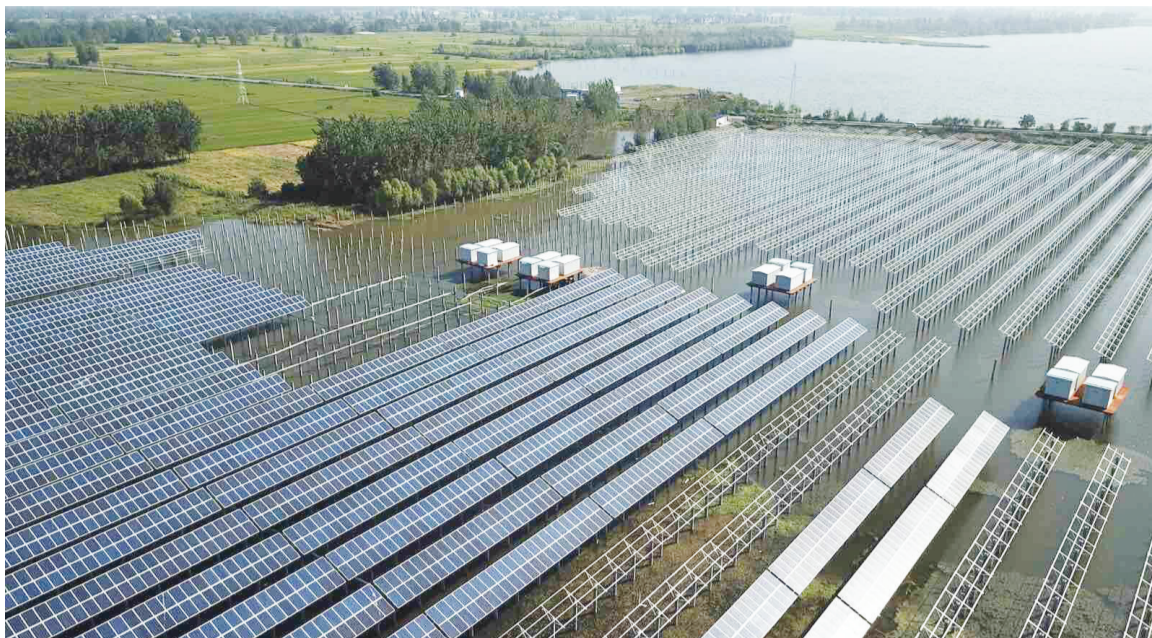
空中俯瞰漂浮光伏电站 李博/图
