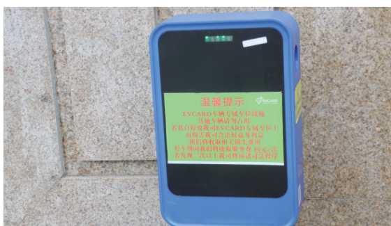
EvCard 充电桩上的警示牌
