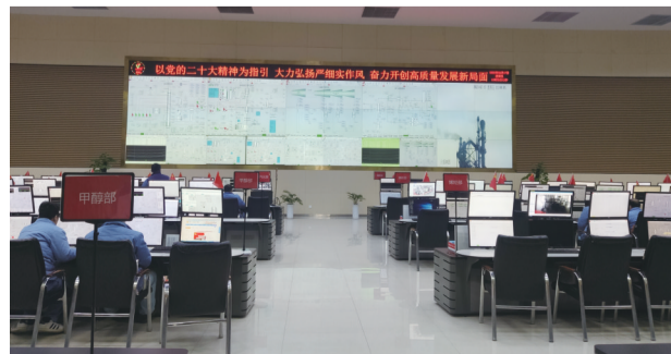
中安联合煤化工有限责任公司中央控制室
